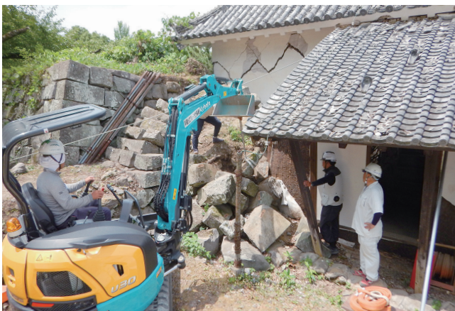
崩落石材回収作業（2019年8月5日撮影）
